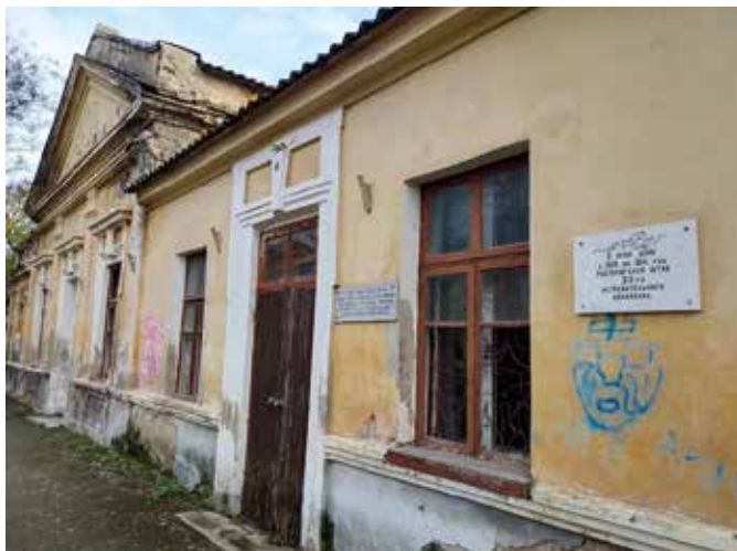
Das historische Gebäude der lutherischen Kirche in Jewpatorija (Beginn des 20. Jahrhunderts) ist in einem beklagenswerten Zustand
